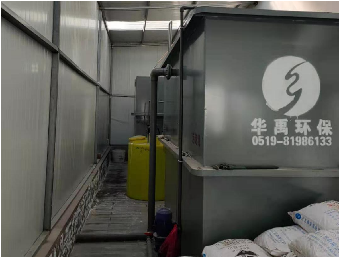
污水和雨水照片：
