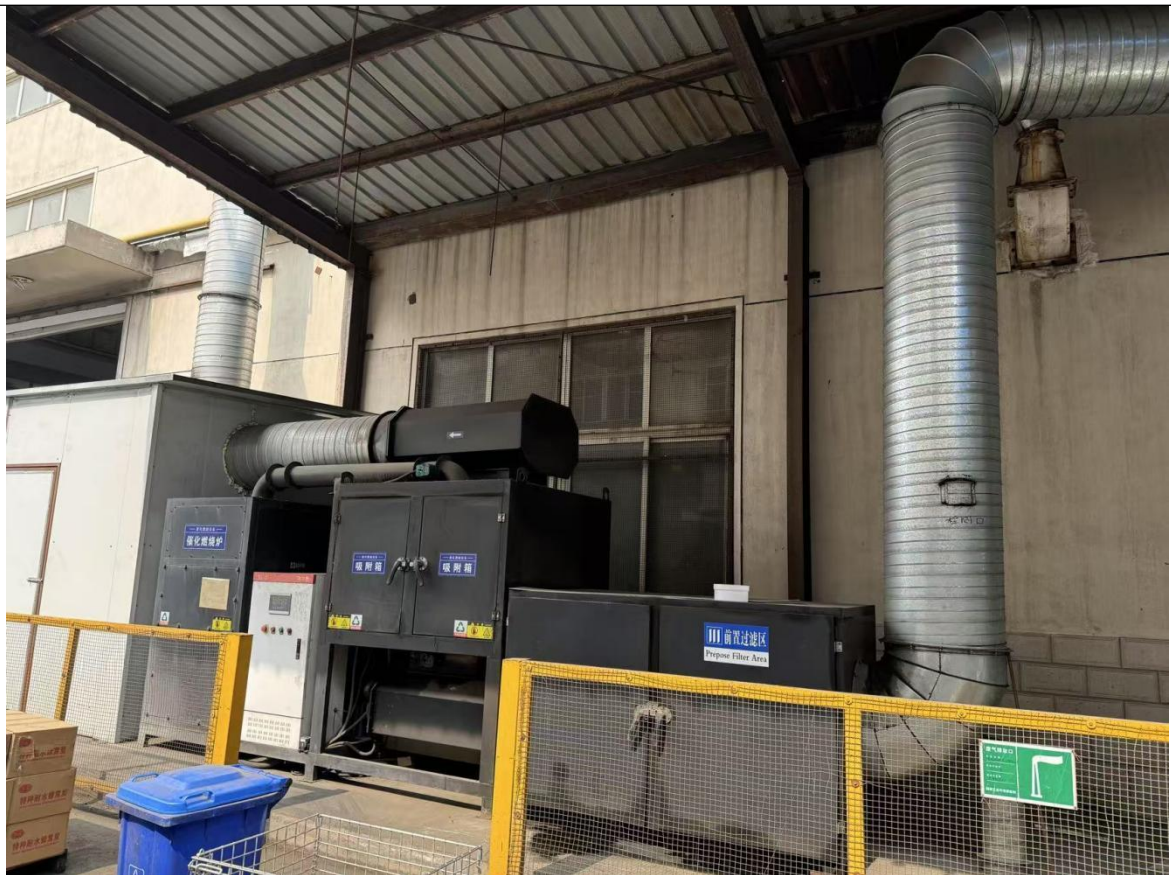
厂区废气处理设施照片：
