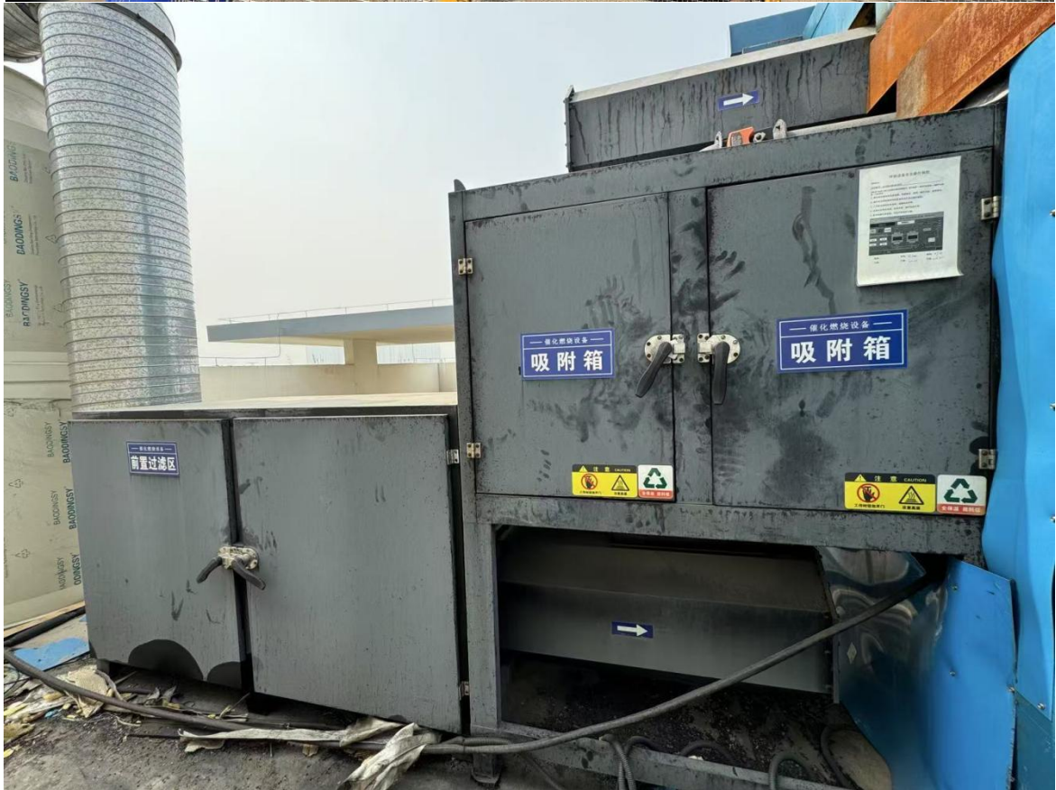
过滤棉+活性炭吸附-脱附+催化燃烧（RCO）照片
