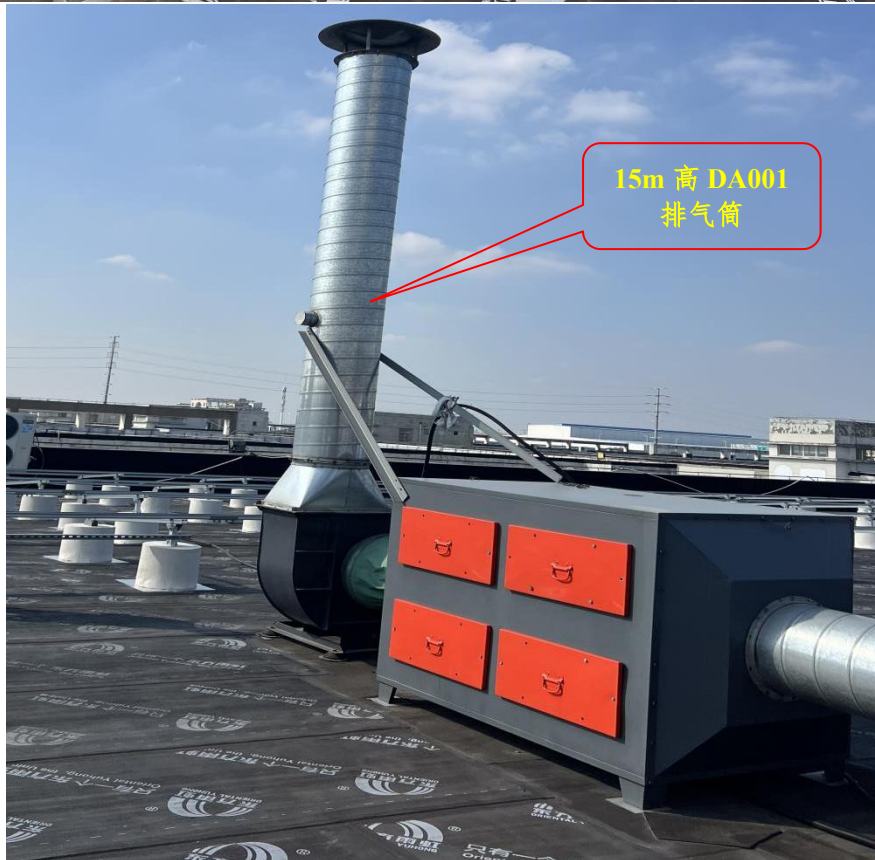
过滤棉+二级活性炭处理装置、废气排气筒照片
